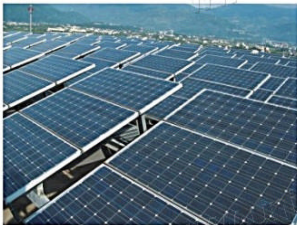
宜蘭地政大樓30kWp市電併聯/緊急供電混用系統
